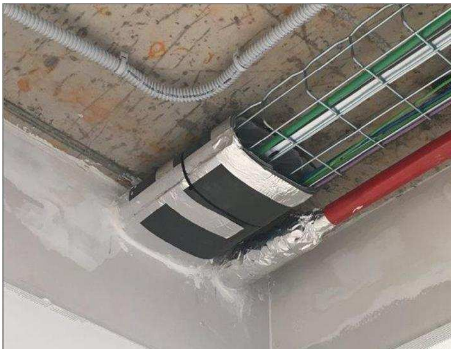
Esempio della corretta esecuzione del trattamento sulla canalina elettrica
