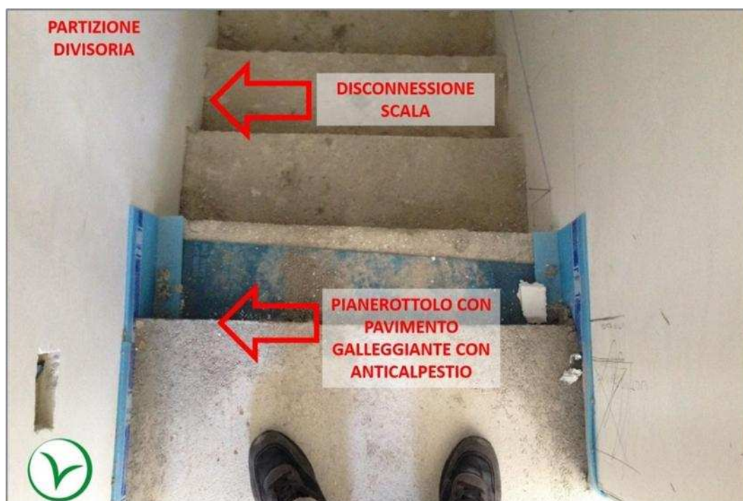
Disconnessione scala e sistema anticalpestio sui pianerottoli
